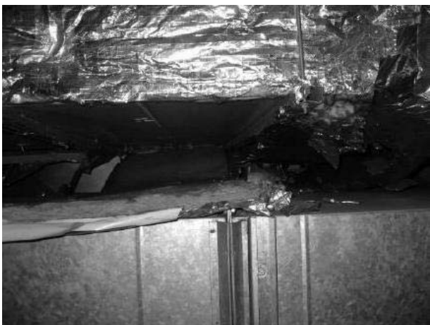
Fehlende Dämmung am Lüftungskanal
