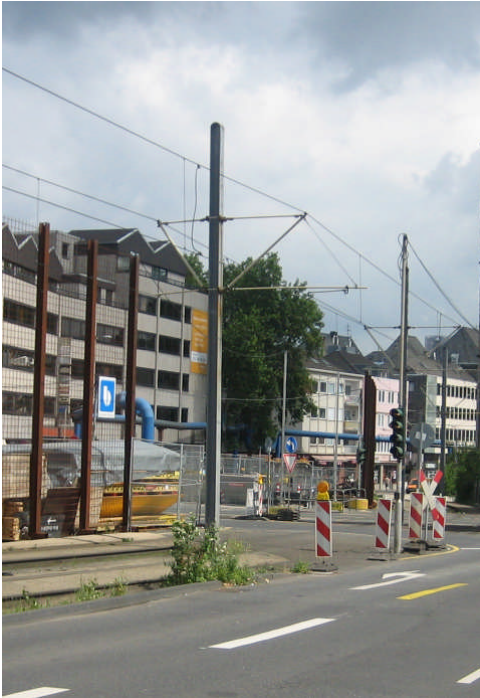
Masten zwischen den Gleisen
