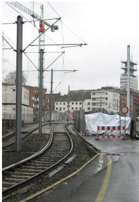
Masten zwischen den Gleisen
