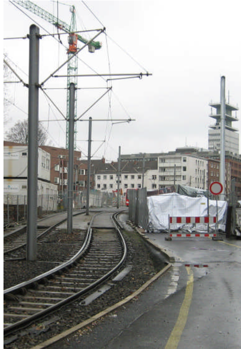
Masten zwischen den Gleisen - neue seitlich
