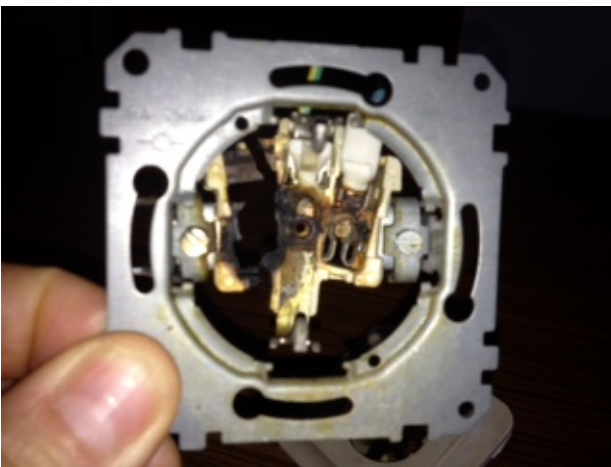
Abbildung einer defekten Steckdose Bauteil C Die Elektroinstallation stammt aus den Jahren 1975/1976. Sie wurde mehrfach erweitert, entspricht nicht dem Stand der Technik
