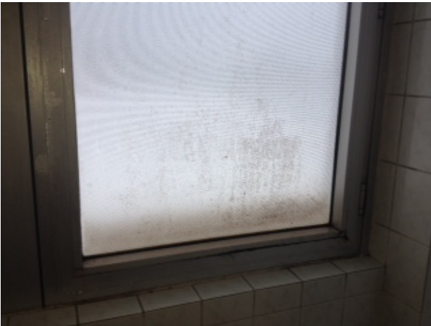
Völlig unisolierte Waschbetonplatten gemeinsam mit einzelverglasten Fenstern mit defekten Beschlägen sorgen für extrem hohe Energiekosten. Feuchteschäden, Schimmel und Temperaturen außerhalb der rechtlichen Vorschriften sind die Folge
