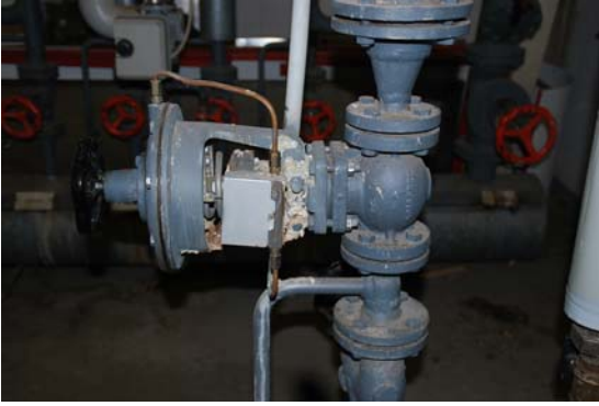
Abbildung eines notwendigen Schiebers der Heizungsanlage Die Schieber der Heizungsanlage sind völlig veraltet und korrodiert, Heizungsausfälle sind die Folge
