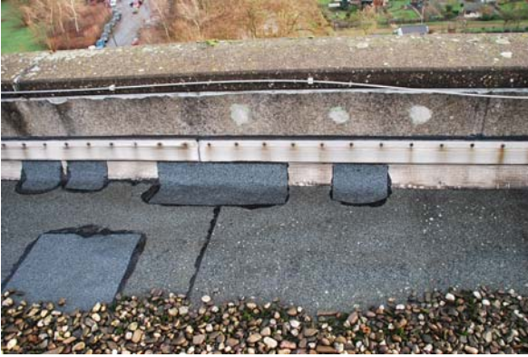
Abbildung des Daches Bauteil A Regelmäßige Wassereinträge sorgen für Gebäudeschäden
