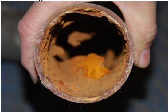
Abbildung einer Frischwasserleitung
