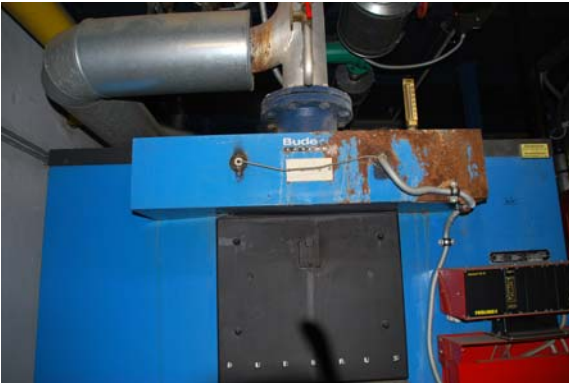
Abbildung eines maroden Kessel aus dem Jahr 1975 Die Kessel sind völlig veraltet und korrodiert, Heizungsausfälle sind die Folge
