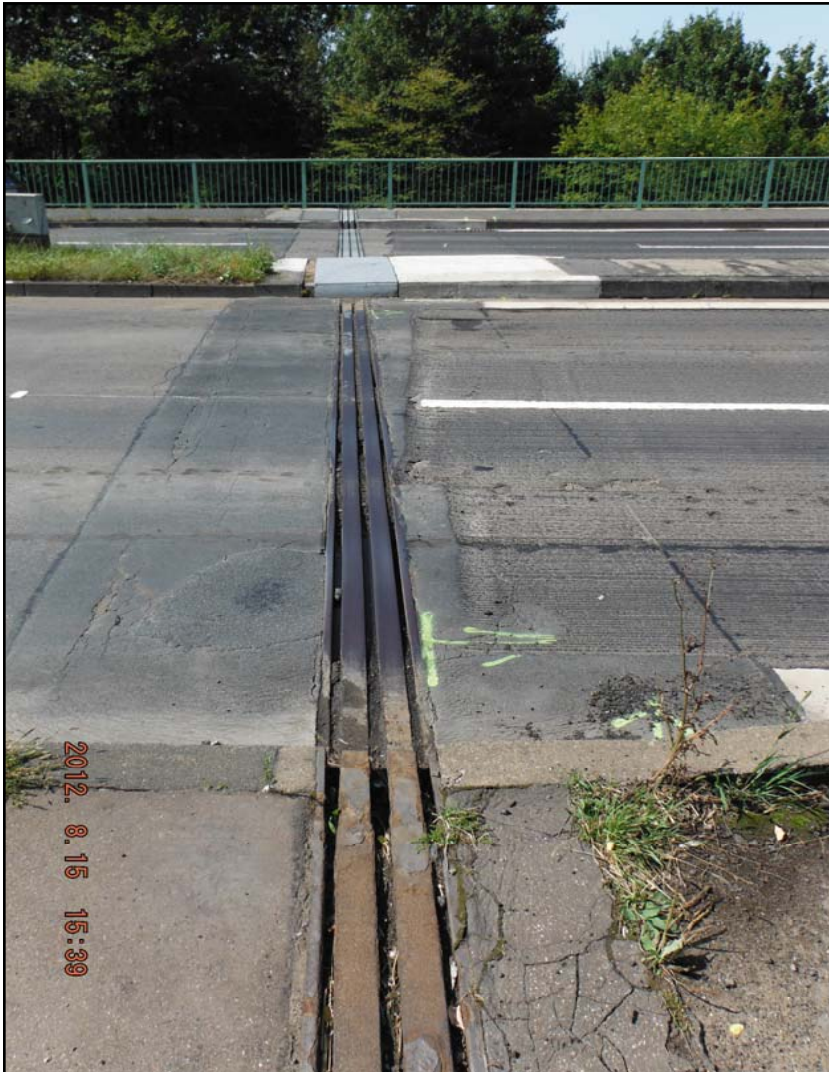
Übergangskonstruktion in Richtung Chorweiler ist rostig und weist Abplatzungen auf.
