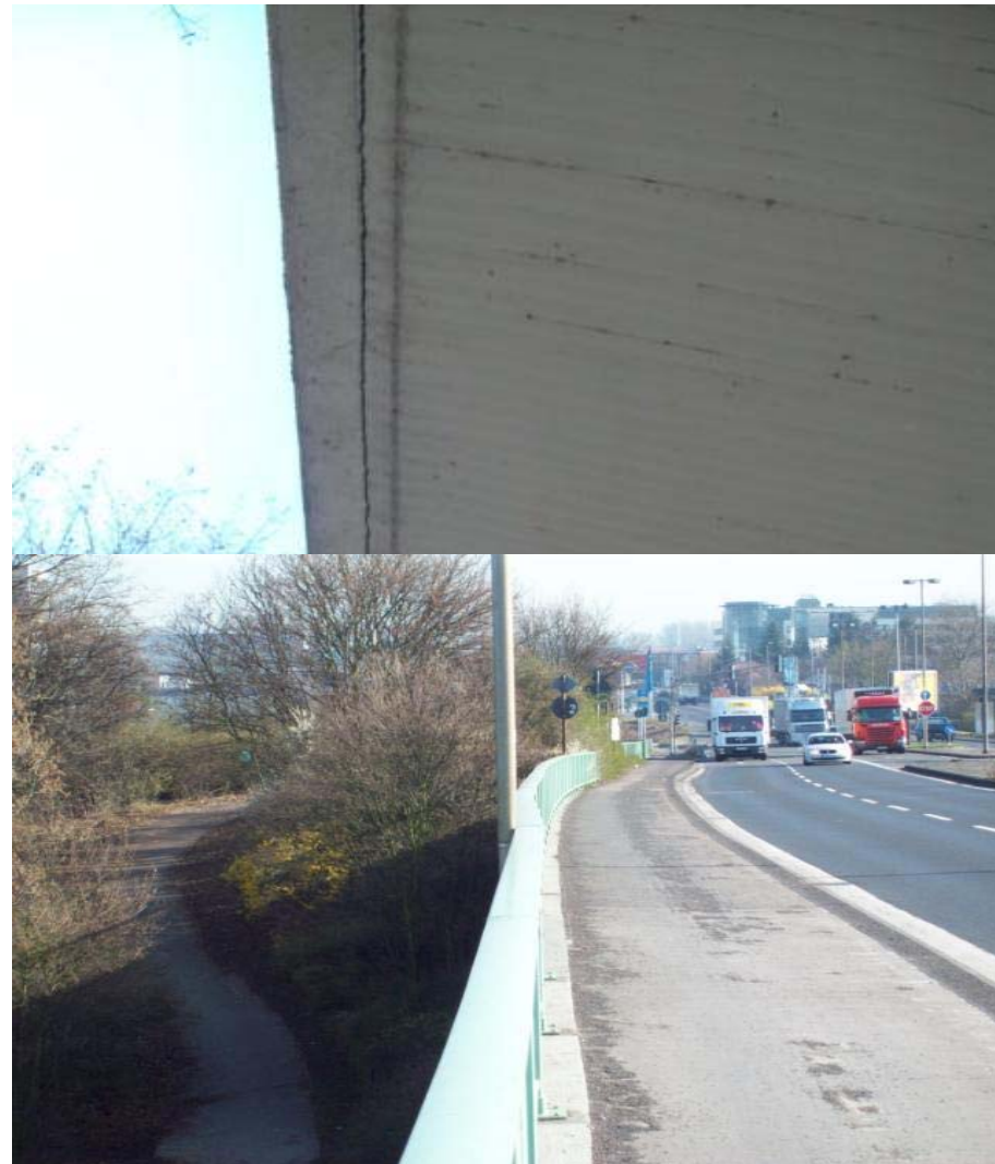
Die Geländer sind oberflächlich verrostet, das Seil im Handlauf fehlt. Das Geländer ist nach ERA 95 1,30 m hoch auszuführen..
