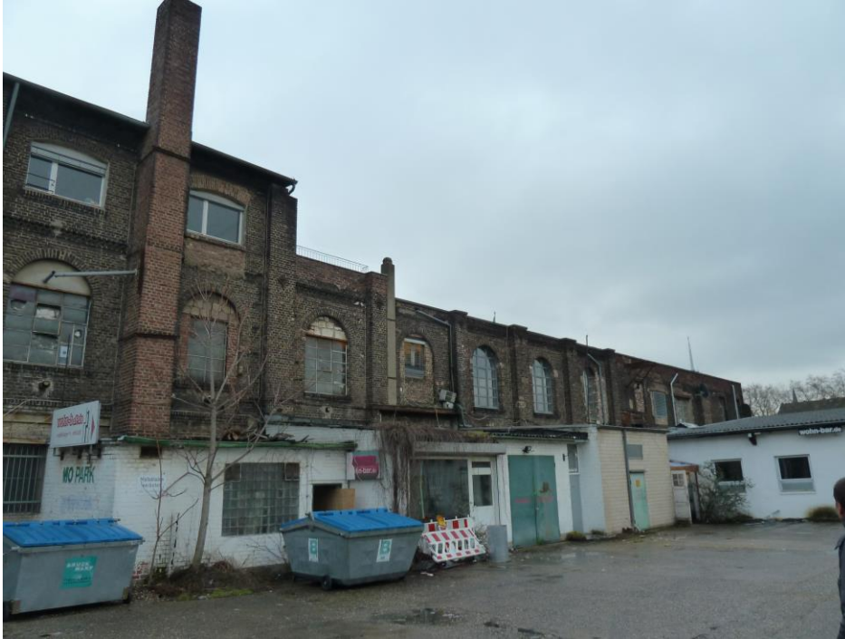
Abbildung: Fassade der Rheinlandhalle zum Schulgrundstück hin, Abbruch der neuen Anbauten, Sanierung der historischen Fassade, Bereich für eine mögliche Aufstockung
