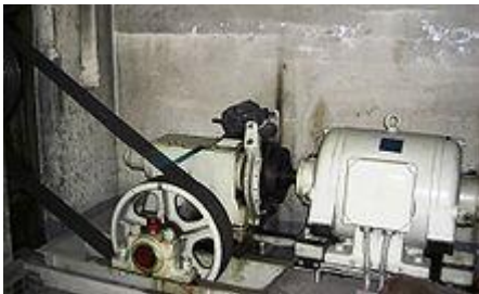
Brunckenmotor in einem Lastenaufzug
