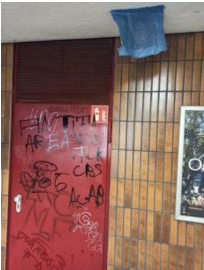
Schmierereien Heumarkt, Übergang unterirdisch
